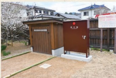
特殊消火器と消火栓
